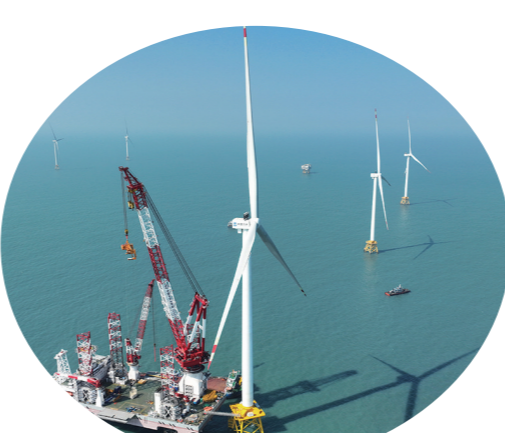
这是2026年1月13日在福建海域拍摄的20兆瓦海上风电机组和“大桥海风”号2000吨自升式海上风电安装平台。
