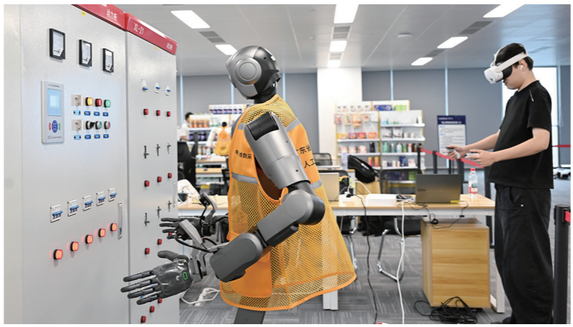
2026年4月7日,在广州海珠区的广东省具身智能训练场,工作人员在模拟环境下训练机器人进行电力设备巡检与维护。
