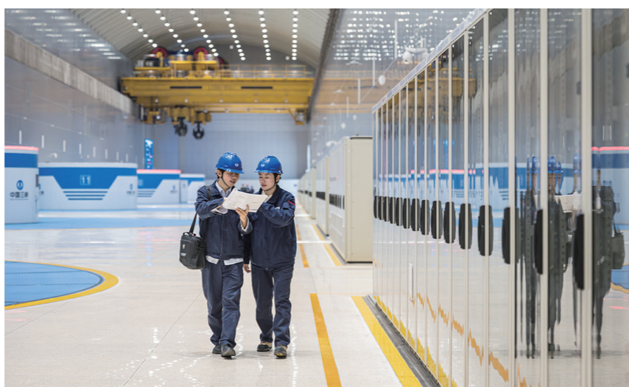
2025年12月26日,工作人员在白鹤滩水电站开展日常巡检工作。
