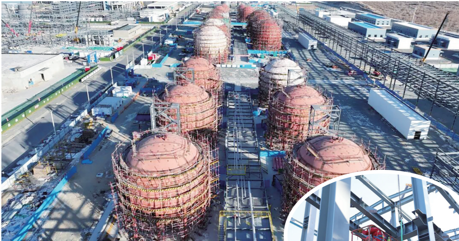
春潮涌动处,奋进正当时。近期,我市各建设单位抢抓开局、争分夺秒推进项目建设,全力冲刺2026年一季度“开门红”,为全市“十五五”高质量发展开好局、起好步。图为在内蒙古荣信化工有限公司年产80万吨烯烃项目施工现场,千余名建设者正协同作业,保障工程高效有序推进。 王星雅 李卓颖 摄
